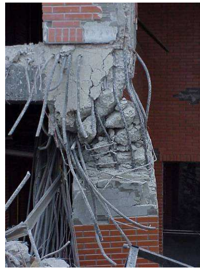
Figure 6-10 : Chi-Chi 1999 - Manque de confinement du nœud de liaison poteau de rive et poutre.
