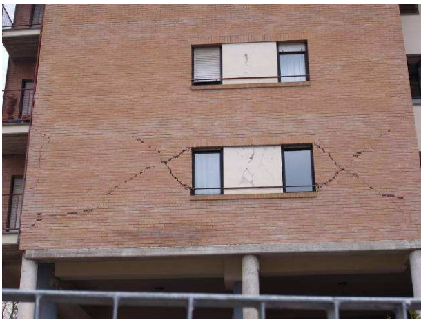
Figure 6-15 : L'Aquila 2009 - Bâtiments d'habitation, fissures de cisaillement.
