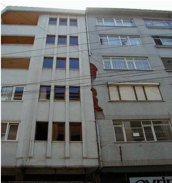
Figure 6-38 : Kocaeli 1999 – Joint de faible ouverture et entrechoquement entre deux bâtiments contigus.
