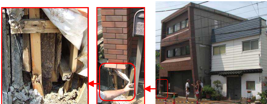
Figure 3-16 : Torsion d’un bâtiment en bois due à l’affaissement du niveau bas par une large ouverture et à la dégradation par l’humidité des poteaux d’angle en bois
