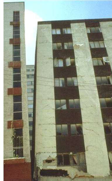
Figure 6-39 : Mexico 1985 – Joint de faible ouverture et entrechoquement entre deux bâtiments contigus.
