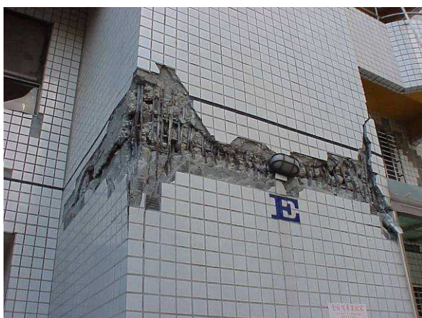
Figure 6-20 : Chi-Chi 1999 – Fissure de cisaillement et rupture de l'enrobage au droit d'une reprise de bétonnage et d'une zone de recouvrement.
