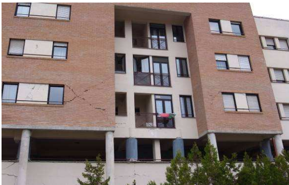
Figure 6-8 : L'Aquila 2009 - Pettino, bâtiment irrégulier en plan et en élévation avec des poteaux courts.
