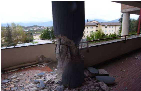
Figure 6-9 : L'Aquila 2009 - Pettino, endommagement de poteaux courts par cisaillement et un manque de confinement transversal.
