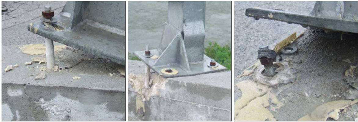
Figure 3-15 : Exemple d’ancrage avec mauvaise adhérence de la cheville chimique (difficile à détecter, si ce n’est la proximité de la cheville avec le nu du mur, ce qui conduit à un ancrage dans une zone de béton non confiné) et trous oblongs surdimensionnés avec rondelles inadaptées (photos mission AFPS L’Aquila, 2009)
