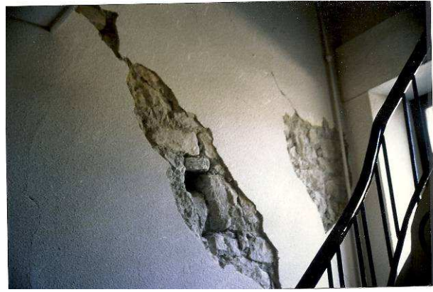
Figure 6-23 : Epagny 1996 – Mairie à murs en pierres non appareillées, fortement endommagée ; le bâtiment a été démoli.
