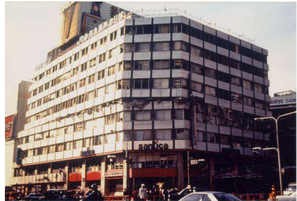
Figure 6-4 : Kobé 1999 – Rupture du 5 ème niveau
