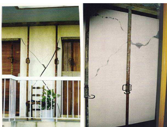
Figure 6-25 : Epagny 1996 – La façade avec baies vitrées est en maçonnerie d'agglomérés de béton ; elle participe au contreventement dans la direction transversale. Les trumeaux entre les baies n'ont pas de chaînage vertical et sont très fissurés (cisaillement). Le bâtiment a été évacué et renforcé provisoirement par des étais.
