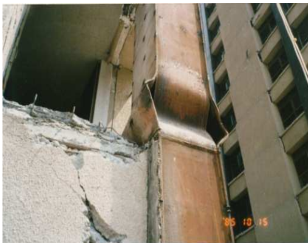
Figure 6-33 : Mexico 1995 – Flambement localisé d’un poteau caisson par défaut de soudure. Sur un ensemble de cinq IGH, deux se sont effondrés.
