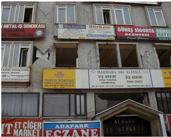
Figure 6-16 : Kocaeli 1999 - Ville d'Adaparazi, fissures de cisaillement au droit des trumeaux.
