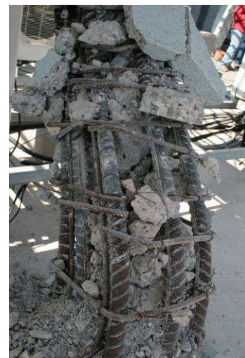
Figure 6-11 : Chili 2010 - Armatures transversales trop espacées et insuffisamment ancrées, pourcentage élevé des armatures longitudinales de diamètre important eu égard aux dimensions du poteau.
