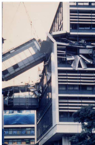
Figure 6-35 : Kobé 1995 – Les passerelles de liaison conduisent à la rupture des éléments verticaux impactés.
