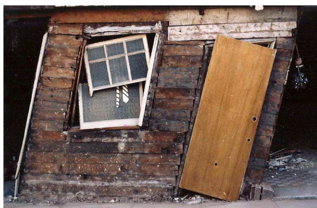
Figure 6-27 : Loma Prieta 1989 – Gros plan sur le rez-de-chaussée du bâtiment de la figure 6-26, illustration de l'absence de contreventement.
