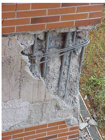
Figure 6-19 : Dommage localisé à l'extrémité d'un voile, malgré la pauvreté du confinement
