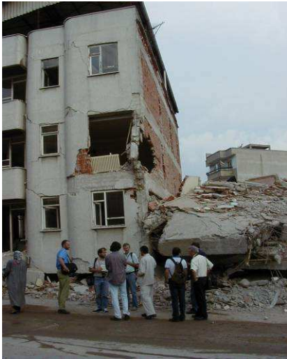
Figure 6-1 : Kocaeli 1999 – Effondrement généralisé du bâtiment de droite et interaction avec le bâtiment mitoyen.
