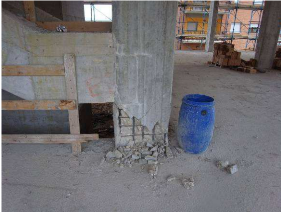
Figure 6-7 : L'Aquila 2009 – Poteau court dû à la liaison avec le limon d'un escalier.
