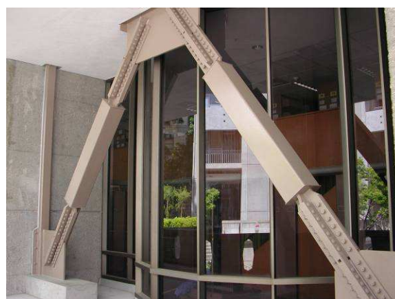
Figure 6-43 : Mise en place d'éléments de stabilité associés à des amortisseurs pour contreventer le niveau rez-de-chaussée de ce bâtiment R+2
