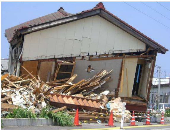
Figure 6-30 : Chetsu-Oki 2007 – Maison individuelle : insuffisance de contreventement.
