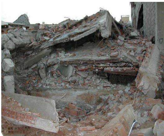
Figure 6-2 : Al-Hoceima 2004 – Effondrement généralisé du bâtiment.
