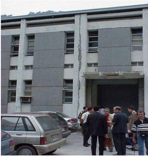
Figure 6-36 : Chi-Chi 1999 – Joint de faible ouverture au droit de deux blocs de la même structure.
