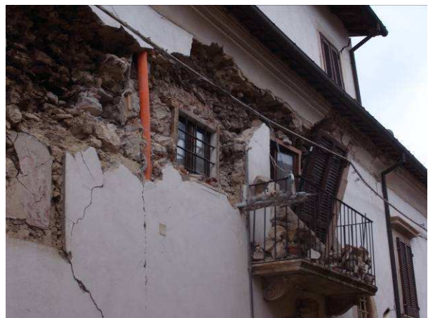
Figure 6-24 : L'Aquila 2009 – Murs en pierres de remplissage : effondrement et destruction d'une partie de l'épaisseur des murs.
