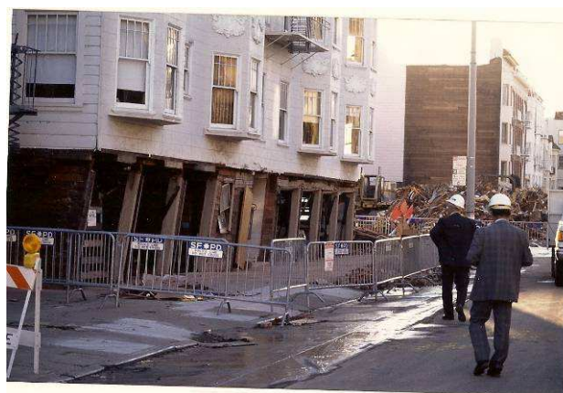
Figure 6-26 : Loma Prieta 1989 – Petit collectif comportant un rez-de-chaussée transparent peu contreventé (San Francisco, zone de la Marina).
