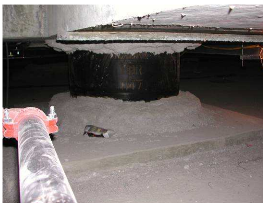
Figure 6-41 : Appui parasismique en place
