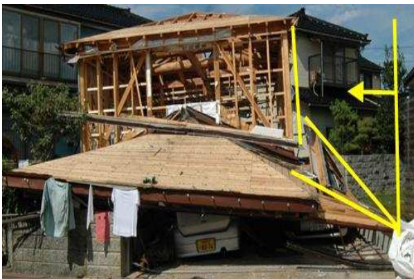
Figure 6-31 : Chetsu-Oki 2007 – Maison individuelle : insuffisance de contreventement.
